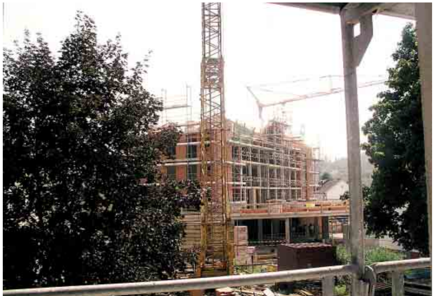
Im Erdgeschoss ist Raum für Läden, Praxen und Büros, auf einer begrünten Platte darüber befindet sich der Wohnbereich.
